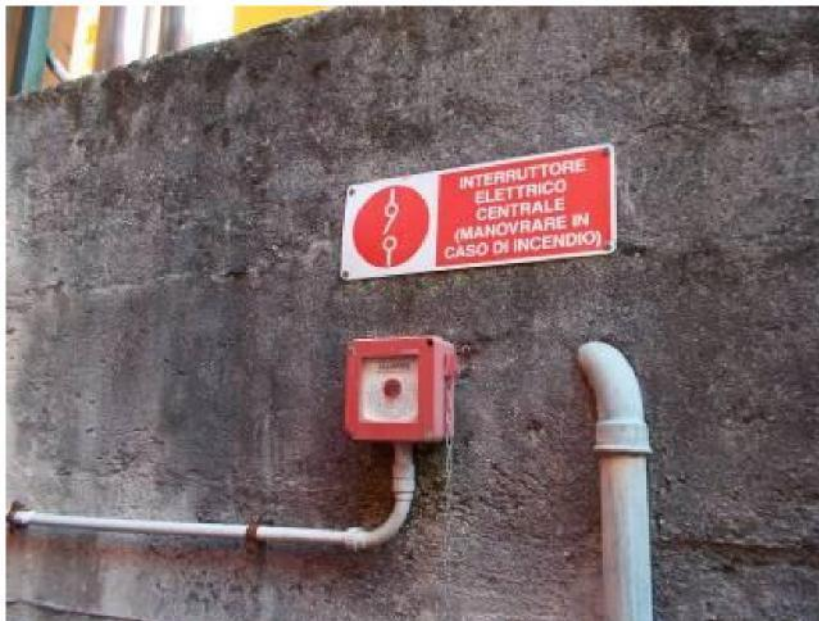
Foto 03: pulsanti sgancio elettrico Istituto comprensivo di Villa Guardia
