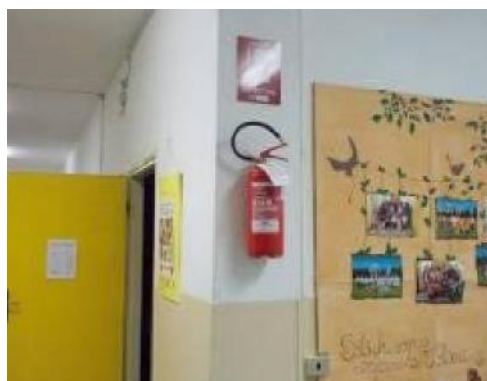
Foto 5: estintore a polvere
