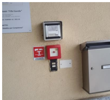
Foto 03: pulsanti sgancio elettrico
