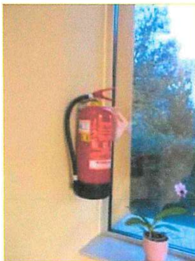
Foto 8: estintore a polvere
