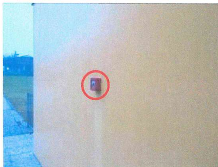
Foto 06: pulsanti sgancio elettrico
